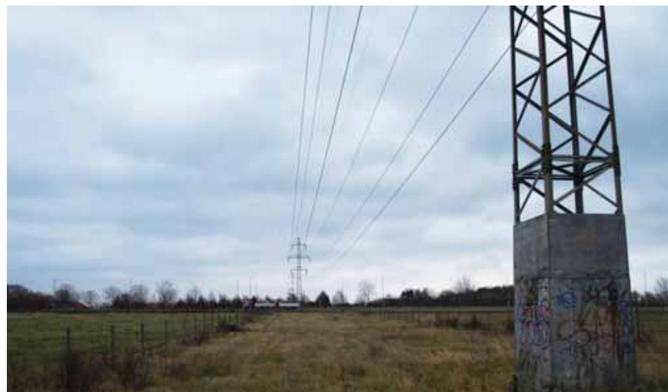
Højspændingsmaster gennem Roskilde råstof- og festivalområde som samles ved transformatorstationen vest for Kamstrup
